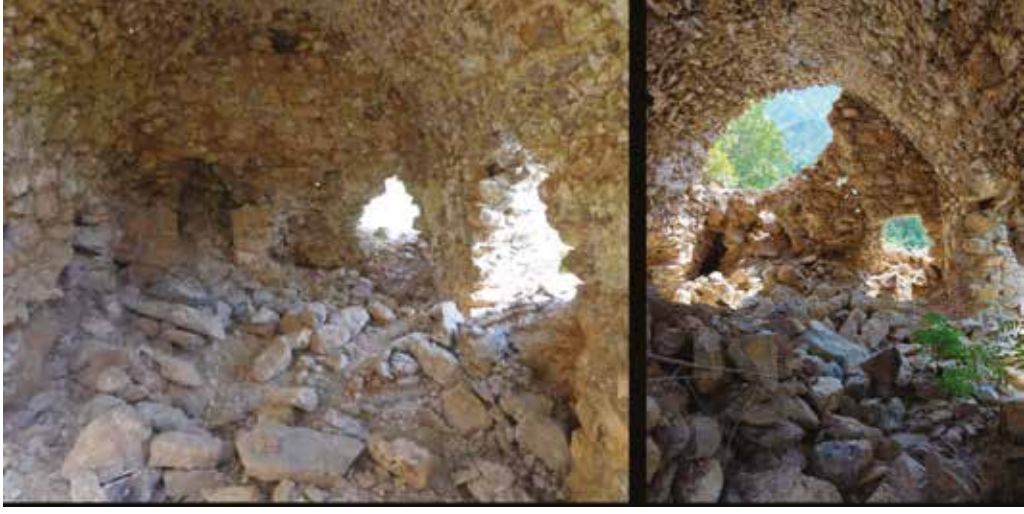
Daglıca yakınlarındaki Aqre / Akre (Akar) Mahallesi'ndeki Aziz Mamas Kilisesi'nin içi, 2015 ve 2019 yılları arasında yapısal bozulma belirtileri gösteriyor. Fotoğraflar: Nicholas Al-Jeloo, 2015 ve 2019.
